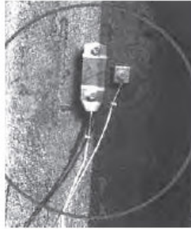
Foto 6: Transductores de aceleración y deformación específica
